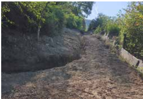
L'orage du 21 juin a également causé des dégâts rue du Cercle. Nous avons creusé un piège à gravier pour sécuriser les habitations.
