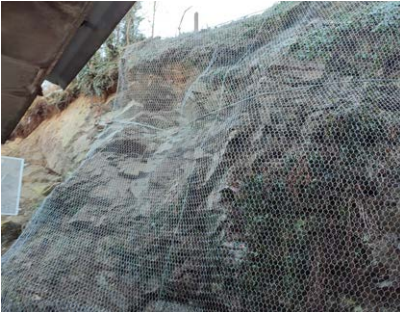
Erosion due probablement à la pluie. Il a fallu consolider la paroi située au début de la rue Brand afin que les riverains soient en sécurité. Impressionnant !
