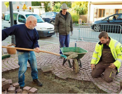
De plus en plus, nos équipes reprennent des travaux mal faits par les entreprises.
